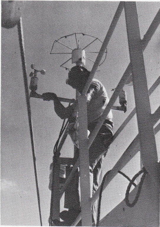
Elektriker Murthy sjekker vindmåleren
