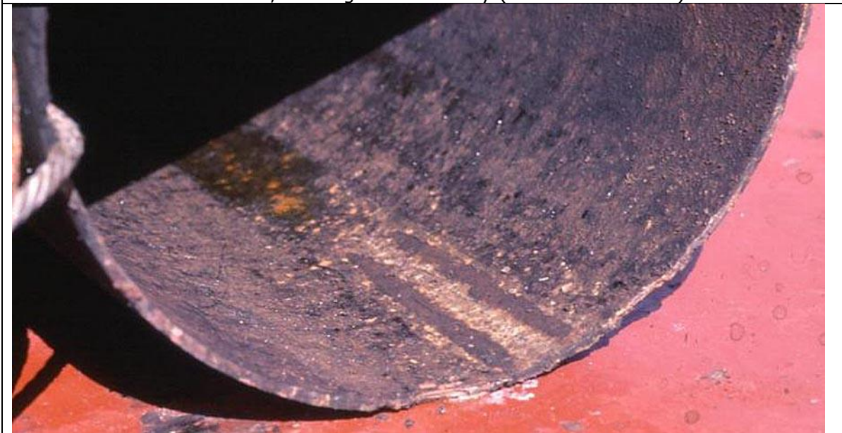
SFJ00119790138101 Jarita, tynnvegget rør (foto: Per Sundfær)
